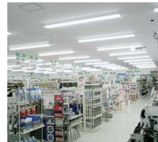
LED照明を導入した新店。蛍光灯と比較して約25%の削減につながりました。
